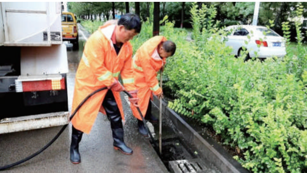
为确保汛期城市排水设施运行安全通畅,全力保障人民群众正常生产生活秩序,朔州市市政管理部门坚持提前主动的迎汛理念,强化汛期检查,尽可能消除排水安全隐患,确保城市安全度汛。 刘磊 吕慧杰 摄
