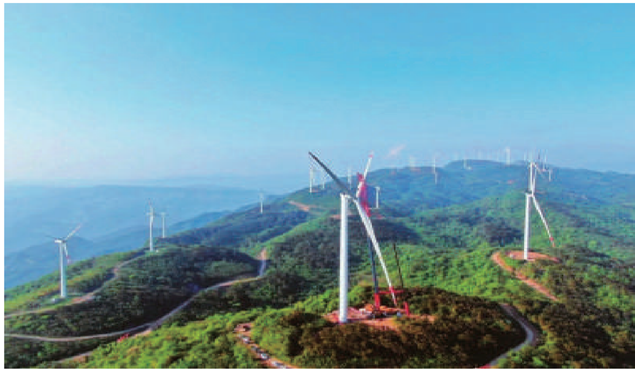
7月30日,中国能建山西电建承建的大唐平鲁白玉山100兆瓦扩容风电项目22台风机全部吊装就位。据悉,该项目位于朔州市平鲁区双墩乡、阻虎乡境内,项目规划总装机容量100兆瓦。项目建成后,预计每年可提供273141.6兆瓦时绿色能源。郝辉 摄
