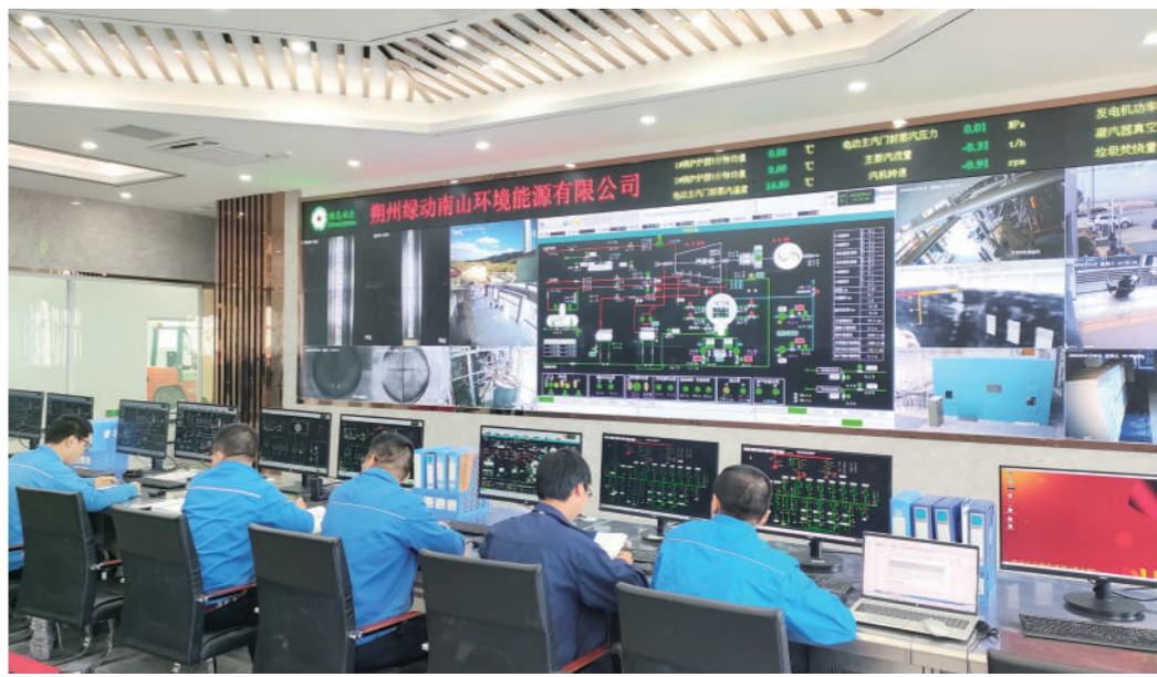
9月27日,市南山环境能源项目的中控室里,工作人员正在密切地关注着各项关键设备的调试运行数据。该项目是我市首个特许经营的垃圾焚烧发电项目,一期项目总投资5.96亿元,投产后,日处理生活垃圾800吨,年处理生活垃圾29.2万吨,年发电量为13.6兆瓦,目前项目已基本完成,将按期正式投产发电。 刘淑花 摄
