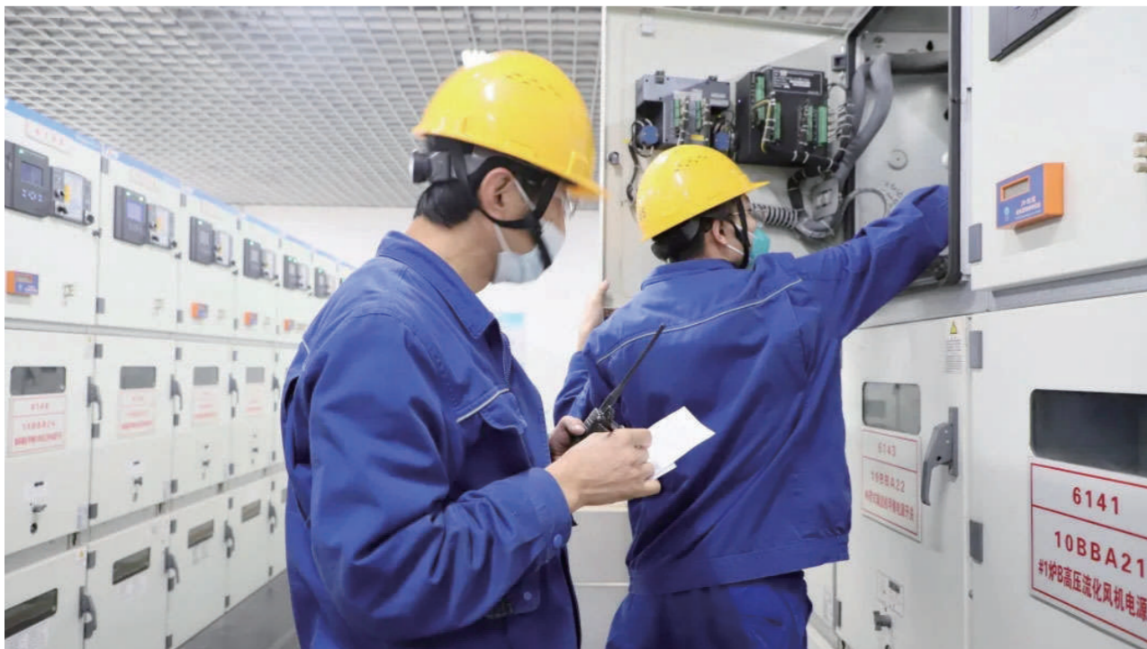
近日,朔州经济开发区重点企业华电朔州热电分公司电气设备巡检人员在认真核对设备参数,精心操作,保障电力、热力生产安全。 麻洁琼 摄
