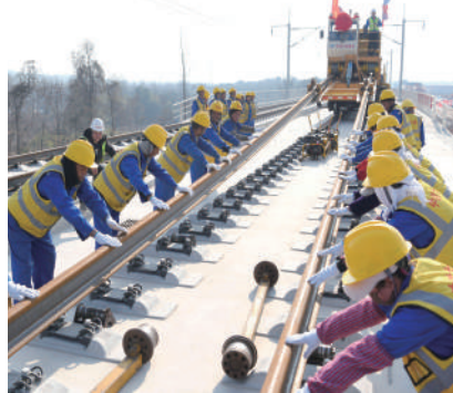
1月16日，中铁六局施工人员在宣绩铁路铺轨施工现场作业。当日，在中铁六局宣绩铁路铺轨施工现场，首对500米长钢轨铺设在无缝轨道板上，这标志着宣绩铁路全线开始铺轨。宣绩铁路位于安徽省宣城市境内，北起宣城市宣州区，南至绩溪县，线路全长111.6公里，设计时速350公里。
