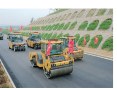
4月11日,无人驾驶压路机在作业中(无人机照片)。当日,由中铁五局承建的沿大别山高速公路鸡公山至商城段JSSG-2标首次运用无人摊铺+北斗高精度定位智能系统,完成全线首段路面中面层试验段铺筑。新华社记者 李嘉南 摄
