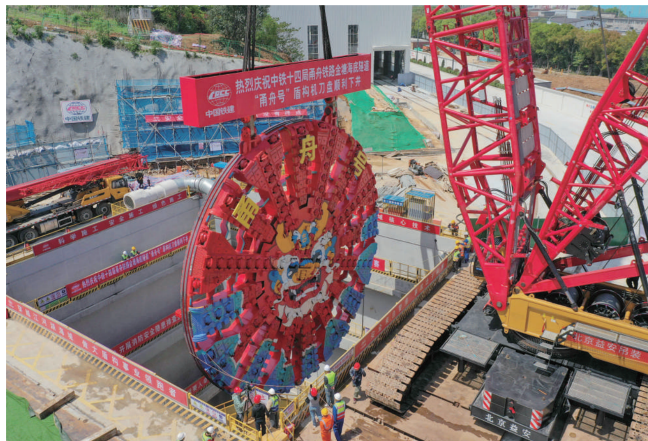
4月18日，“甬舟号”盾构机刀盘被履带式起重机从地面吊运至甬舟铁路金塘海底隧道宁波侧盾构始发井（无人机照片）。当日，由中铁十四局集团承建的甬舟铁路金塘海底隧道宁波侧“甬舟号”盾构机刀盘顺利吊装下井，为甬舟铁路金塘海底隧道盾构机始发穿海奠定基础。
