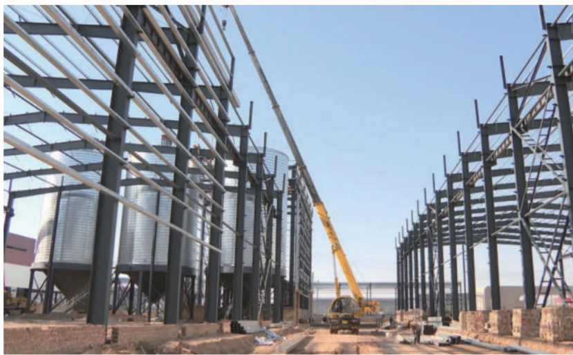
储备车间的主体工程都在有序推进中。项目负责人谭祖国说：“我们现在在1号厂房，目前只剩隔墙没有完成。后面的2号厂房，因为是交叉施工，里面有装设备的，要等设备装上去才能封顶。3号厂房已经把主体结构”
