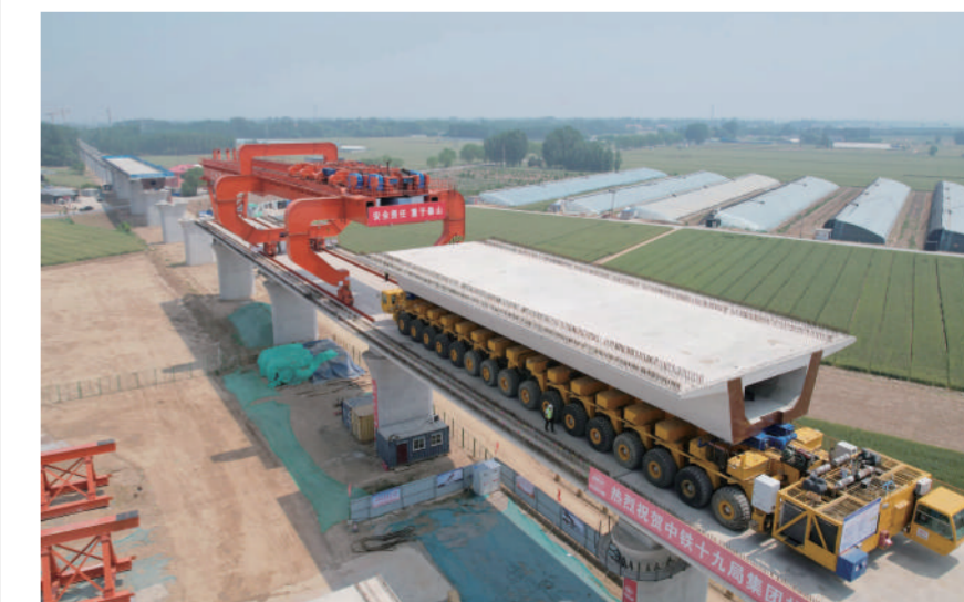
5月23日,中铁十九局的工人在雄商高铁河北段肃宁东站前三标段进行架梁作业(无人机照片)。目前,国家重点工程雄(安)商(丘)高铁河北段建设正在按照建设节点要求稳步推进。雄商高铁是我国高速铁路网“八纵八横”之京港(台)通道的重要组成部分,正线全长552公里,设计时速350公里。 新华社记者 杨世尧 摄
