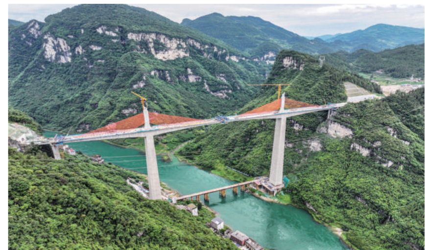
这是6月9日拍摄的渝湘复线高速磨寨乌江特大桥建设现场（无人机照片）。近日，位于重庆市彭水苗族土家族自治县境内的渝湘复线高速磨寨乌江特大桥进入最后一节2米连续梁浇筑施工作业，该桥即将实现全桥合龙。磨寨乌江特大桥由中铁建重庆投资集团有限公司投资、中国铁建港航局集团承建，桥梁全长708米、主跨296米。渝湘复线高速总里程280公里，平均桥隧比80%。新华社记者 唐奕 摄
