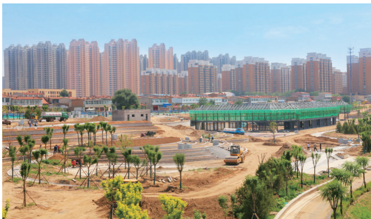
近日,在七里河生态环境综合治理二期工程施工现场,建设工作者战高温、斗酷暑、赶进度,到处呈现一派热火朝天、如火如荼的建设场景。随着两岸绿化景观公园工程的推进,步道修建、地被铺设、绿化灌溉等工作也在有条不紊地进行。赵福胜 摄
