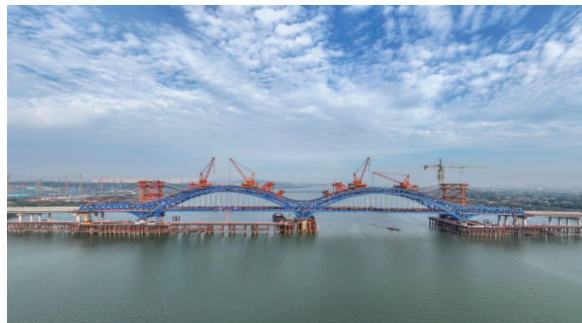
这是11月26日拍摄的长沙暮坪湘江特大桥合龙施工现场(无人机照片)。当日,随着主跨合龙段最后一根横梁安装完成,长沙暮坪湘江特大桥顺利合龙。
