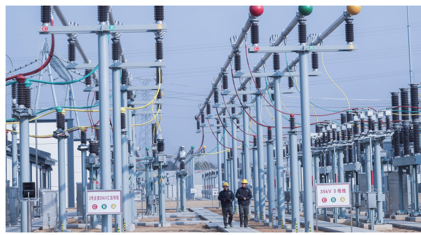
1月21日,在长兴500千伏变电站工程长兴变电站,工作人员巡查设备运行情况。当日,位于浙江省湖州市长兴县的长兴500千伏输电工程正式竣工并网投产,这是2025年浙江电网投产的首个超高压工程。长兴500千伏输电工程是浙江重点能源项目,变电容量200万千瓦,年供电量可达70亿千瓦时。 新华社记者 徐昱 摄
