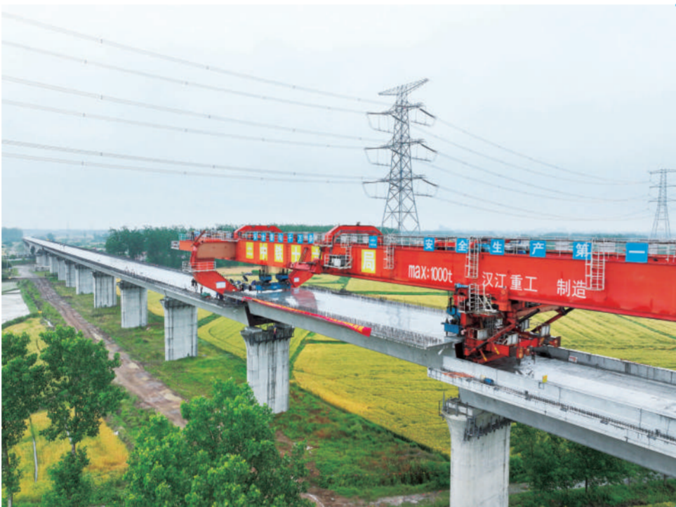
图为中铁十六局宁淮城际铁路项目最后一根混凝土箱梁架现场。5月24日,在江苏省淮安市金湖县境内的中铁十六局宁淮城际铁路项目建设现场,随着最后一根混凝土箱梁稳稳落在桥墩上,宁淮城际铁路淮安段圆满完成箱梁架设任务,为后续无缝轨道板加快施工奠定坚实基础。 宁淮城际铁路新建线路全长约179公里,设计时速350公里。项目建成运营后,将与徐盐高铁、连镇高铁等互联互通,对于完善区域城际轨道交通网络布局,便利沿线群众出行、助力长三角一体化高质量发展等具有重要意义。 新华社记者 季春鹏 摄
