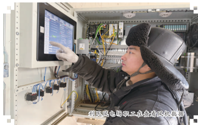
利民风电场职工进行设备巡检
