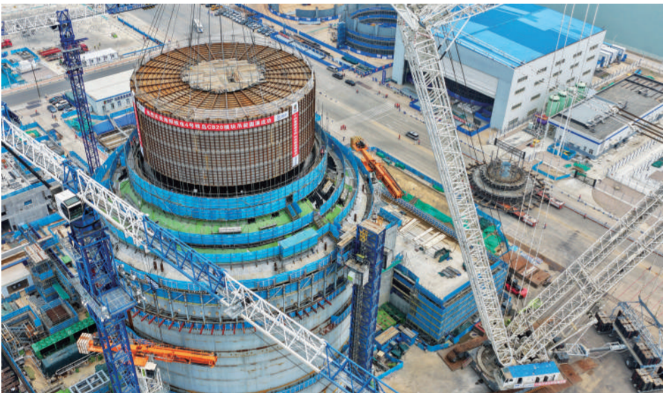
在山东海阳核电站,大型起重机起吊4号机组核岛非能动安全壳冷却水箱。6月29日,重达419吨的国家电投山东海阳核电站4号机组核岛非能动安全壳冷却水箱顺利吊装就位,标志着海阳核电二期工程大型模块全部吊装完成。据了解,建设中的海阳核电3、4号机组采用自主设计的国产化技术,2027年全面投运后,一、二期工程全部4台机组年发电量可达400亿千瓦时。新华社发 唐克 摄
