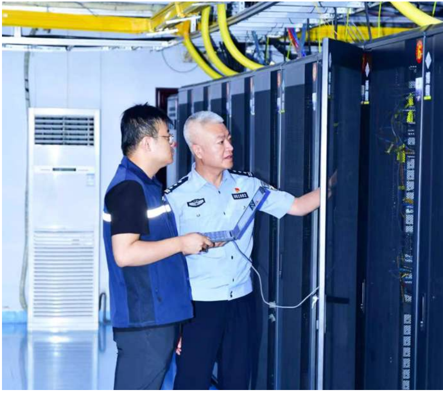
王亮（右一）检查机房设备运行状况
